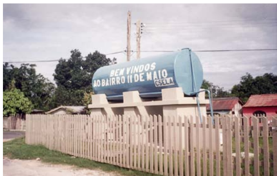
Das Wasserreservoir auf dem höchsten Punkt von Lago, 50'000 l Inhalt.
